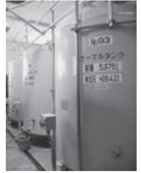
冷温管理を行うサーマルタンク
